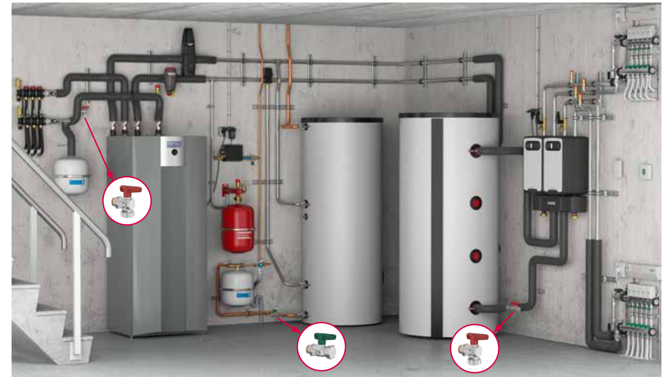
Exemple : petite chaufferie
